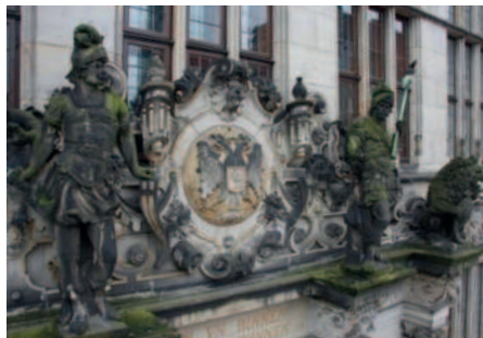
Schadensbild Obernkirchender Sandstein, Bremen
