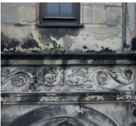
Schadensbild Oberkirchener Sandstein an der Handelskammer Bremen Schütting
